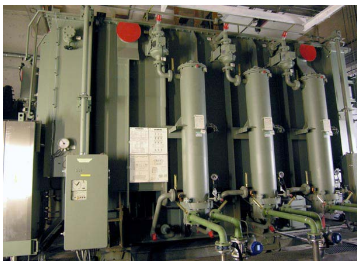
Transformador Scott, 50 MVA con refrigeración aceite-agua
